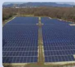
東武岩舟太陽光発電所 (東武エネルギーマネジメント)
