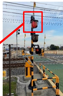
△全方向型踏切せん光灯
