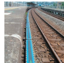
転落支障報知装置（マットスイッチ）
