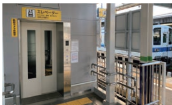
エレベーター
