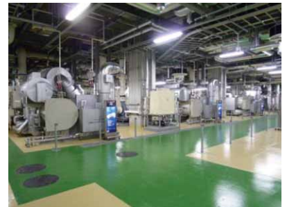
東京スカイツリー地区の主な熱供給施設
