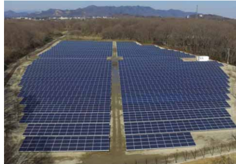
東武岩舟太陽光発電所
