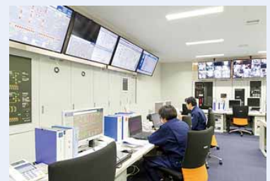
東京スカイツリータウンを一元管理する防災センター (東武ビルマネジメント)
