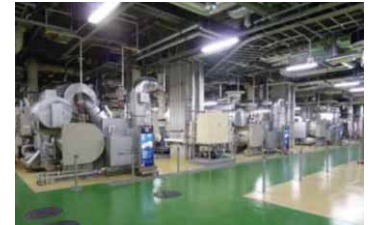
東京スカイツリー地区の主な熱供給施設
