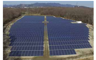
東武岩舟太陽光発電所
