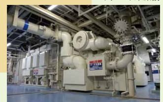
▼ターボ冷凍機
