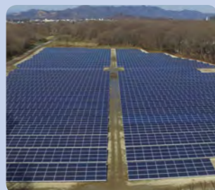
東武岩舟太陽光発電所 (東武エネルギーマネジメント)
