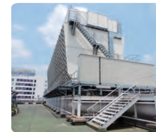
西池袋熱供給施設
