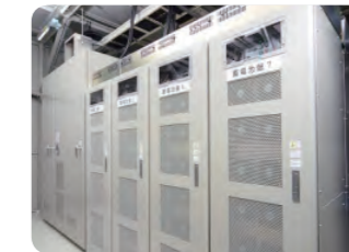
回生電力貯蔵装置
