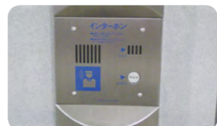
非常用インターホン
