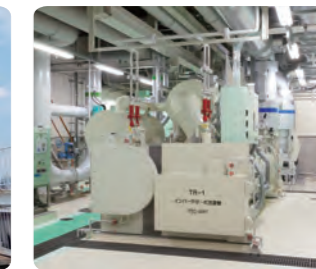
錦糸町熱供給施設
