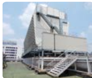
西池袋熱供給施設
