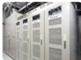
回生電力貯蔵装置
