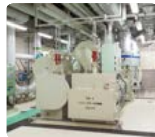
錦糸町熱供給施設
