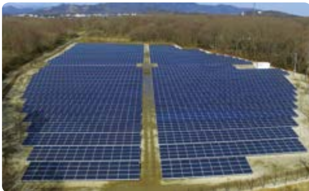
東武岩舟太陽光発電所
