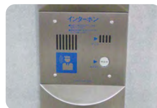
非常用インターホン
