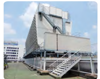
西池袋熱供給(サブプラント)
