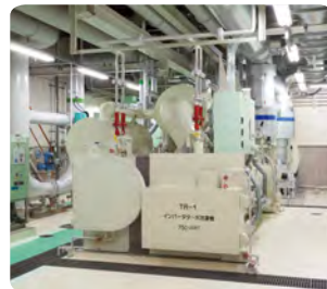
錦糸町熱供給(プラント)
