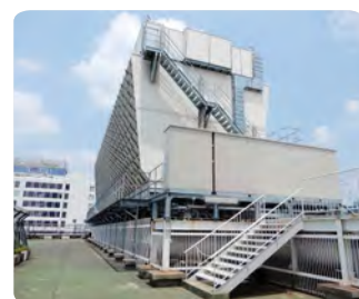
西池袋熱供給(サブプラント)
