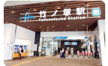
竹ノ塚駅改札口天井照明
