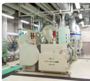
錦糸町熱供給(プラント)
