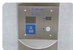
非常用インターホン
