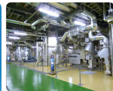
東京スカイツリー地域の熱供給施設
