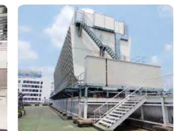
西池袋熱供給 (サブプラント)
