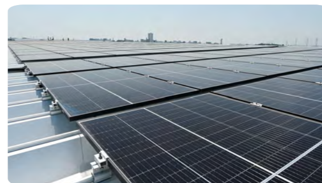
物流倉庫の屋根に設置した太陽光パネル
