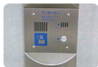
非常用インターホン
