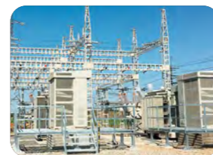
設備機器のかさ上げ
