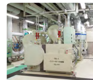
錦糸町熱供給 (プラント)
