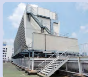
熱供給施設(サブプラント) (西池袋熱供給)
