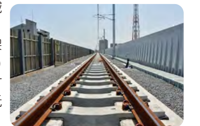
弾性枕木直結軌道
