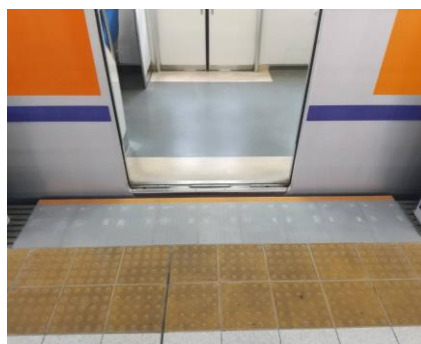
△くし状ゴム設置状況
