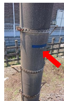
△浸水深マーキング
