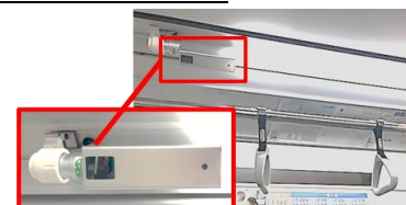
△車内防犯カメラ (車内LED灯部)
