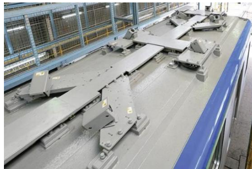
△架線モニタリング装置
