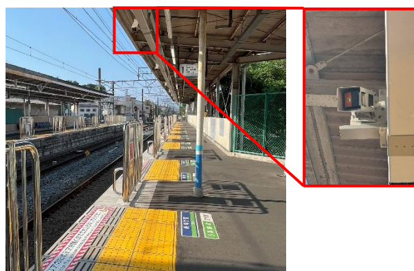
△固定式ホーム柵およびホーム監視装置
