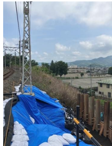
【土砂流出現場 7月24日 現在】
