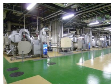
△東京スカイツリー地区の主な熱供給施設
