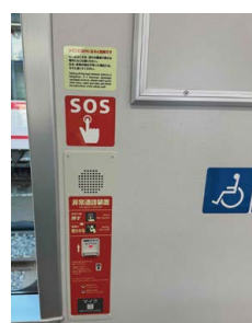
【非常通話装置】
