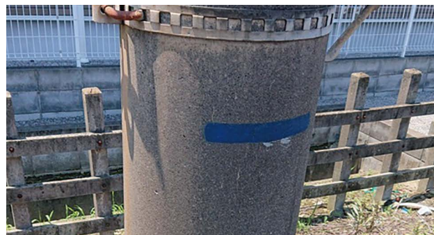
【浸水深マーキング（鷺宮～花崎間）】
