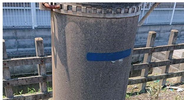
【浸水深マーキング（鷺宮駅～花崎駅間）】
