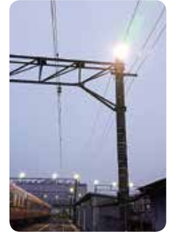
南栗橋車両管区 春日部支所構内照明器具
