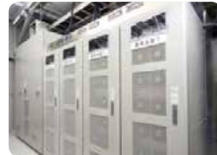
回生電力貯蔵装置
