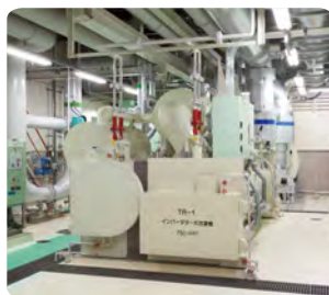
錦糸町熱供給（プラント）
