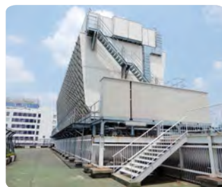
西池袋熱供給（サブプラント）
