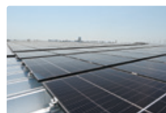
東武商事太陽光発電所
