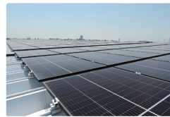
東武商事太陽光発電所
