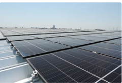
東武商事が設置した太陽光発電所
