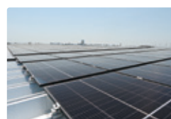
東武商事太陽光発電所
