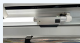
防犯カメラ設置
